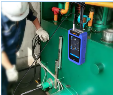
现场悬挂使用
